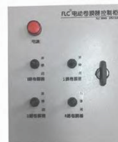
Блок управления для электропривода 24В (снаружи)
